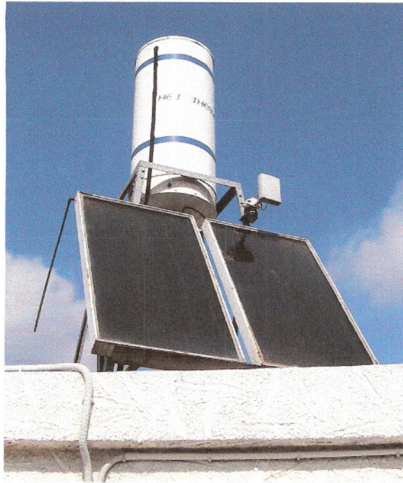
Φωτογραφία 3: Άποψη του σταθμού βάσης κινητής τηλεφωνίας της εταιρείας COSMOTE ΑΕ επί της Λεωφ. Κηφισίας 303 του Δήμου Κηφισιάς Νομού Αττικής
