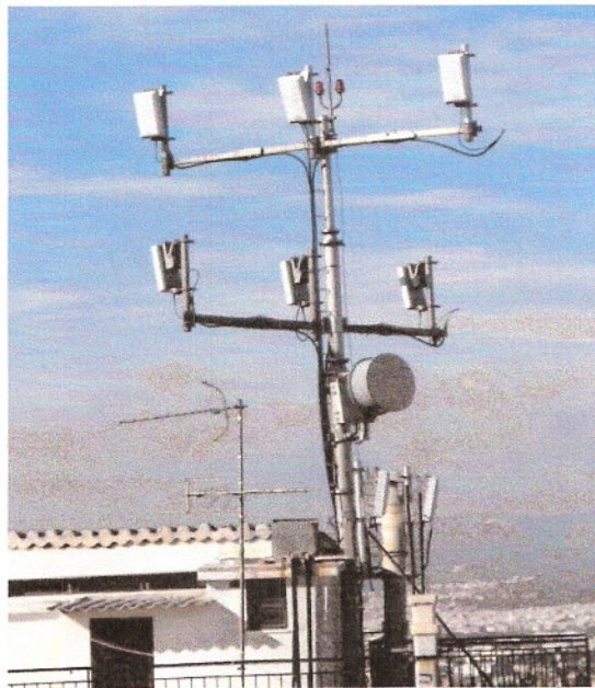
Φωτογραφία 4: Άποψη των κεραιοδιατάξεων αναμετάδοσης κινητής τηλεφωνίας της εταιρείας VODAFONE-PANAFON ΑΕΕΤ επί της οδού Κόδρου 3 του Δήμου Κηφισιάς
